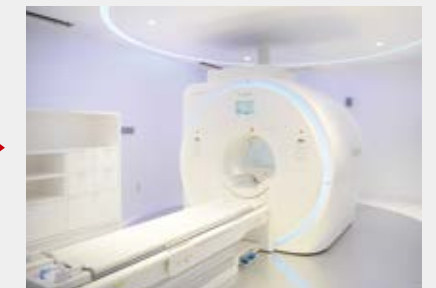
完成後のMRI室
